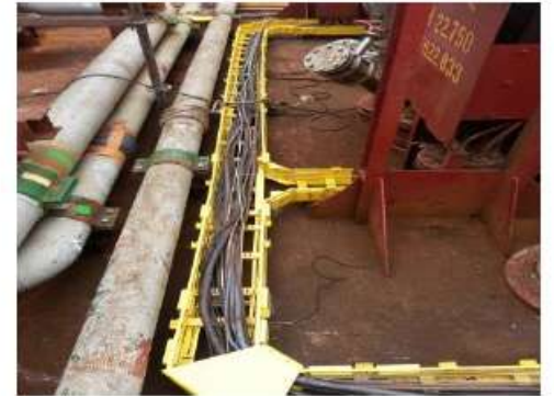
TRAY 설치 후 전선 배열
