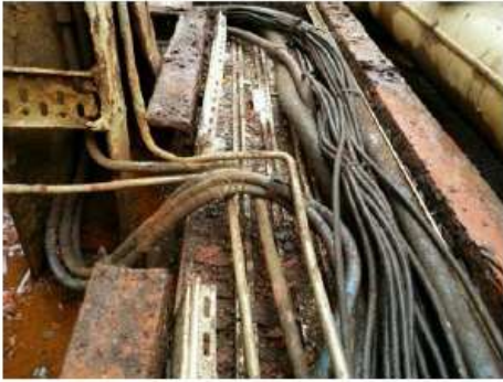
TRAY가 거칠고 녹이 발생하여 전선이 손상될 염려가 있음
