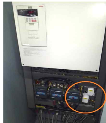
인버터의 제어용 MC채터링 방지로 인버터 다운방지
